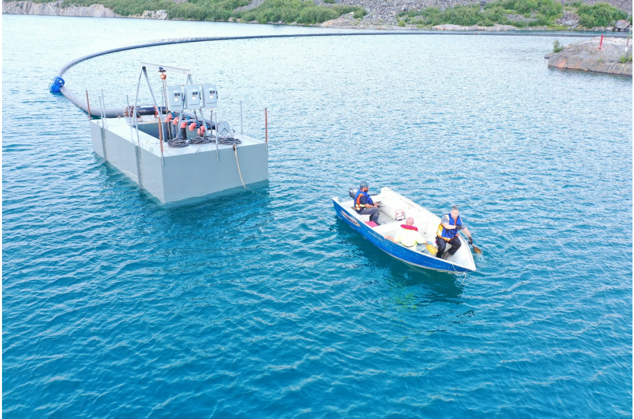
Photo 1 : Les employés de Troilus installent une barge comportant trois pompes de 140 HP dans la fosse J4. L'eau pompée de J4 circule dans une canalisation pour être traitée avant d'être libérée dans le milieu environnant.
