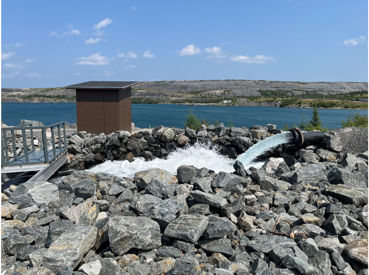
Photo 2 : L'eau pompée de la fosse J4 est traitée avant d'être libérée dans l'environnement. La température, le niveau de pH et le débit sont continuellement surveillés.
